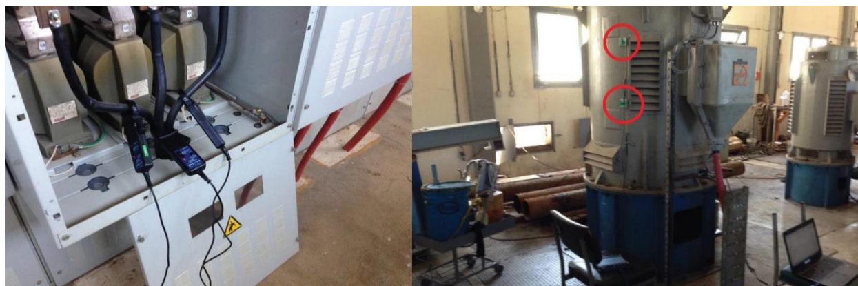
Установленные датчик: слева – датчики тока, справа – датчики магнитного потока
